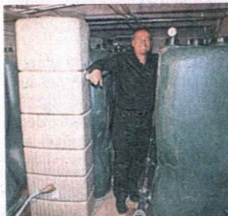
8000 Liter Regenwasser fassen die Sammel tanks im Keller.
